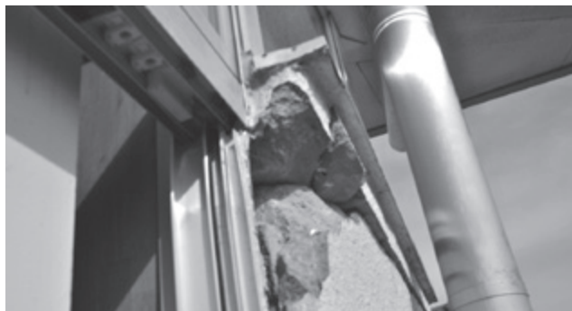
▲新地小体育館外壁に亀裂
