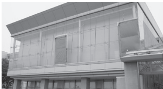
▲図書館南側窓が破損
