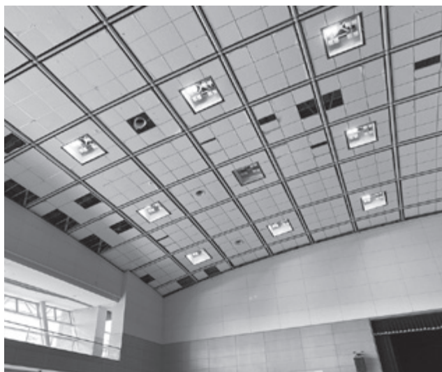
▲崩れ落ちた総合体育館の天井
