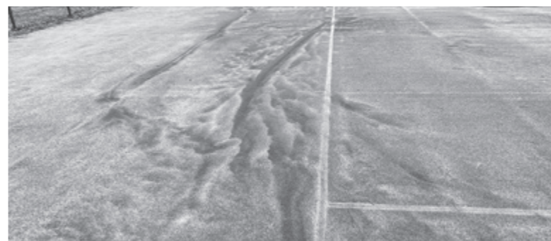
地割れしたテニスコート
