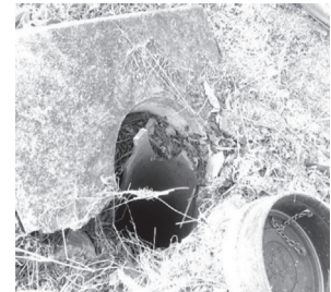
▲公共汚水ます破損状況
