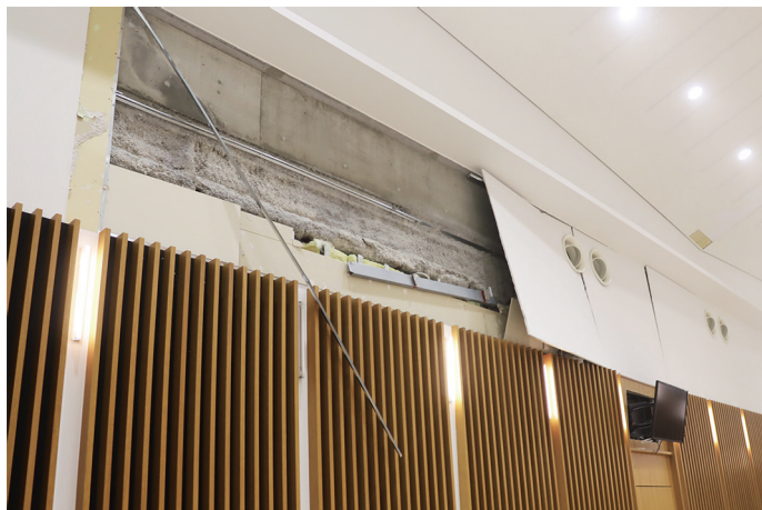
議会議場の壁が落下
