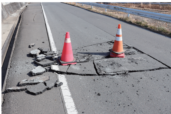
舗装道路のひび割れ
