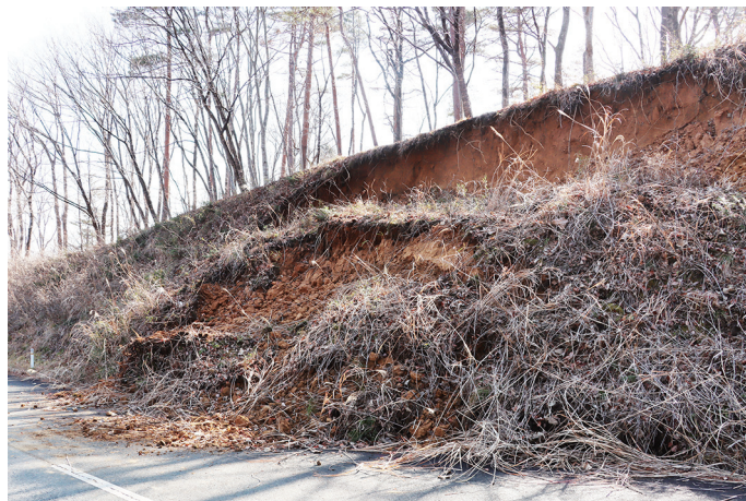
杉目地区での土砂崩れ
