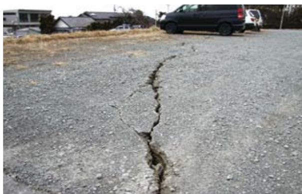
写真 2-6 地割れが発生した地面
