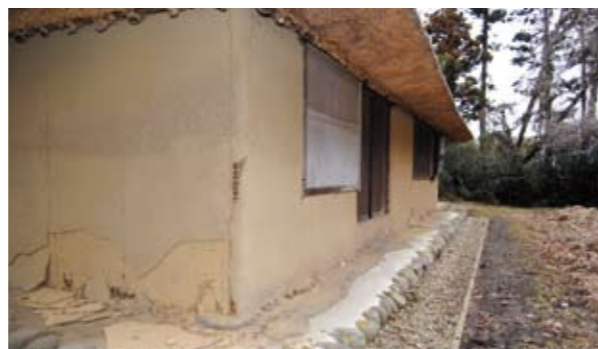
写真 2-72 地震直後の様子。壁の亀裂などが確認できる
