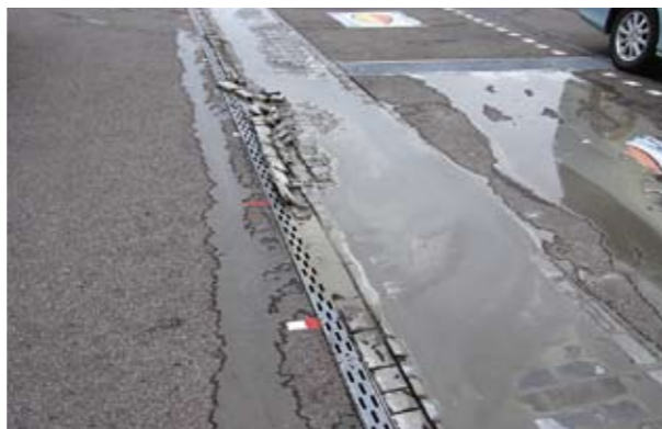
写真 2-4 液状化現象のため地表に水が噴出
