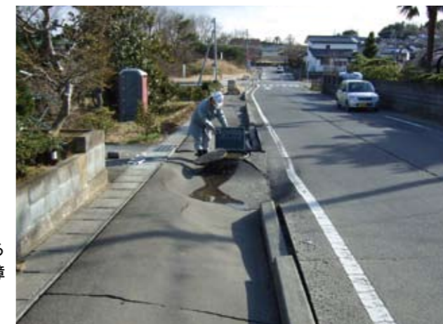
写真 2-69 下水道状況の調査 陥没や隆起などがいたる所で見られ、通行に支障をきたした [3月23日 撮影]
