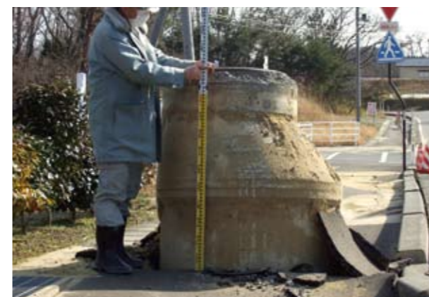
写真 2-70 隆起したマンホール [3月19日 撮影]
