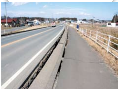
写真 2-103 道路と歩道にできた溝
