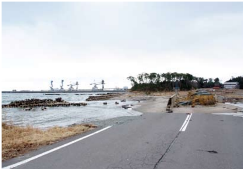
写真 2-99 津波により分断された道路（今泉地区）
