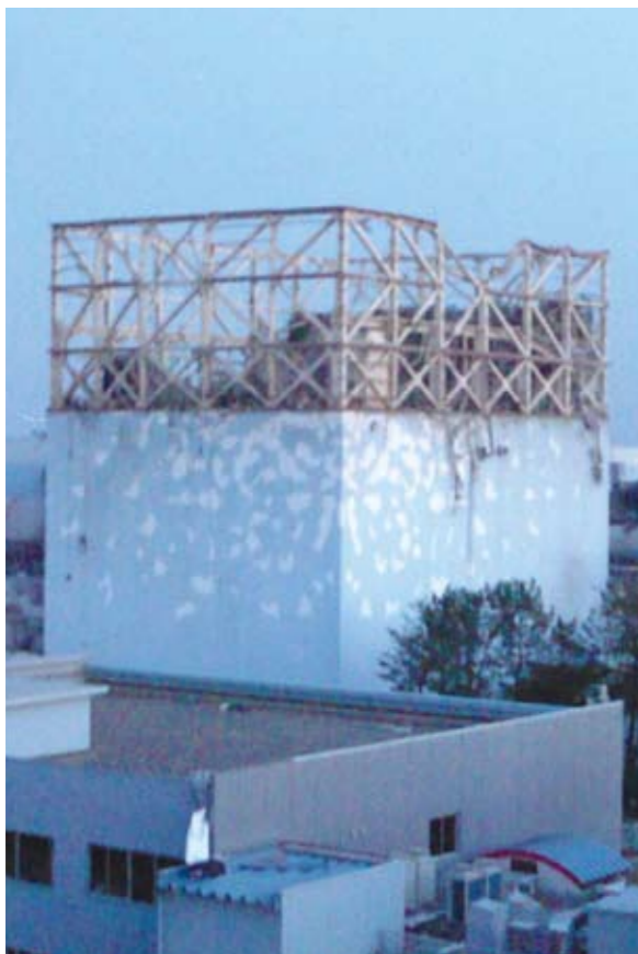
写真 2-63 爆発した1号機 [3月12日 東京電力(株)提供]
