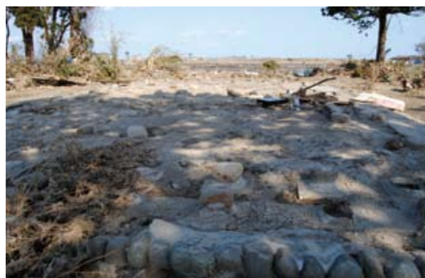
写真 2-74 建物は流失し、基礎部分のみが残った
