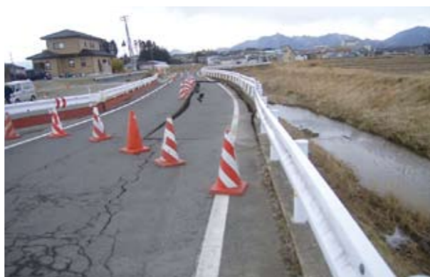
写真 2-5 ひび割れにより通行止めになった道路
