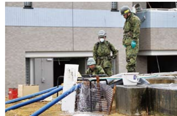
写真 2-135 排水作業を行う自衛隊 新地浄化センターは津波により壊滅的な被害を被り、復旧に向けて自衛隊による排水活動が実施された
