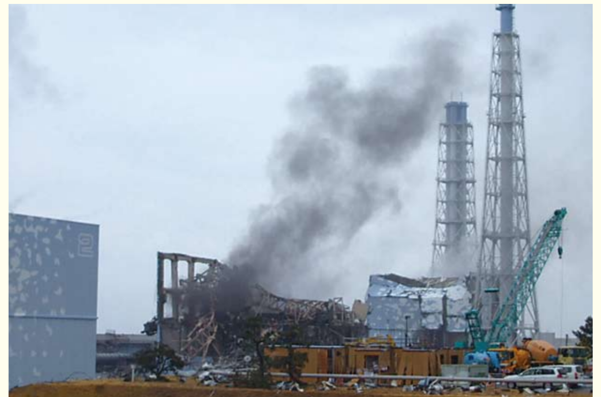
爆発後の3号機 [3月21日 東京電力(株)提供]
