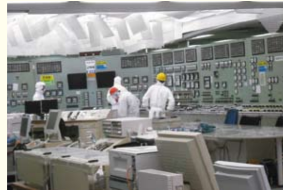
2号機中央制御室 [3月26日 東京電力(株)提供]
